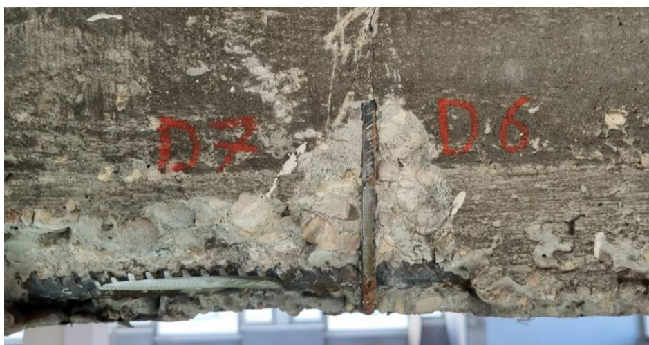
Figura 3. Dettaglio della preparazione della superficie di due barre d'armatura per la prova di durezza in situ.
