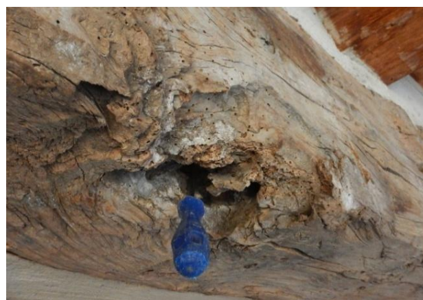
Figura 25. Degrado biologico in corrispondenza di difettosità.
