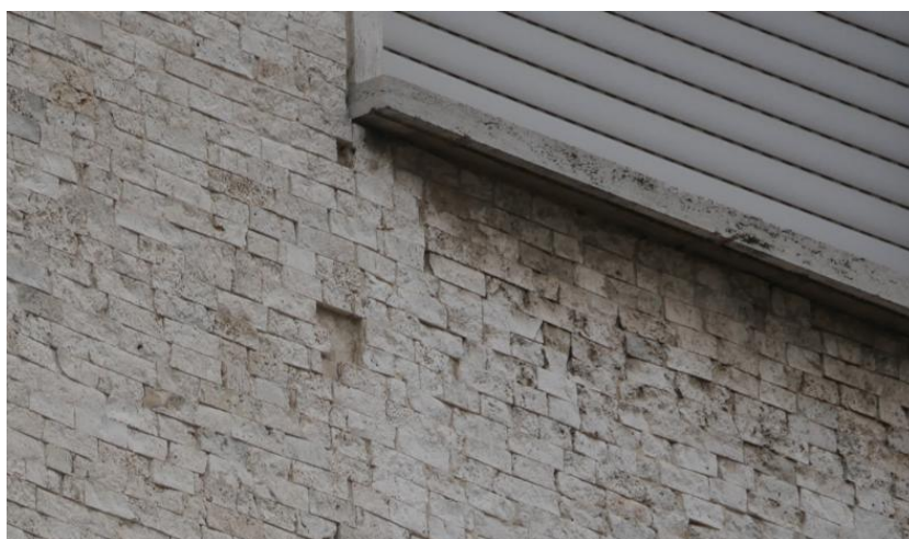
Figura 8. Pre-intervento (facciata nord): mancanze di alcuni elementi di travertino.
