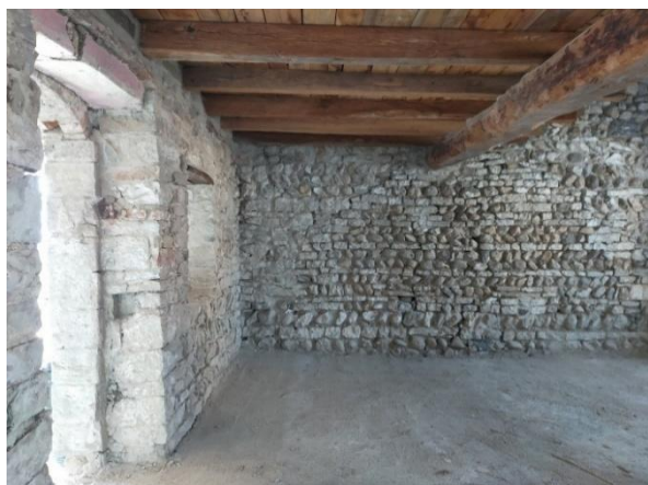
Figura 22. Muratura in ciottoli con solaio a orditura semplice.
