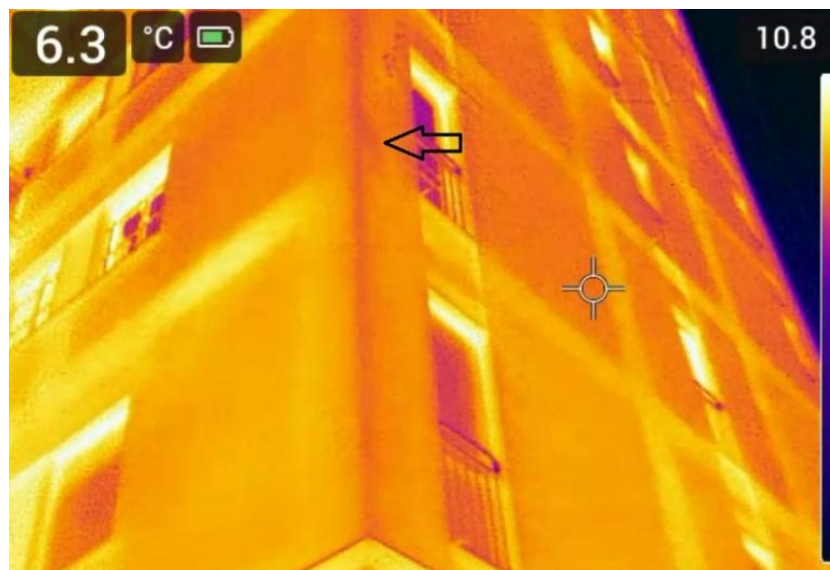
Figura 11. Termografia che rileva la presenza di un distacco del rivestimento in corrispondenza dello spigolo del fabbricato.
