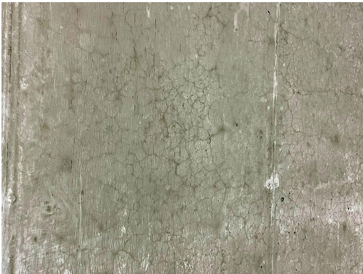
Figura 5. Quadro fessurativo da evaporazione superficiale presente sulle elevazioni.
