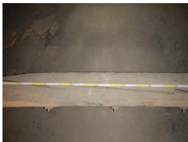
Figura 17. Giunto a dardo di Giove sulla catena.
