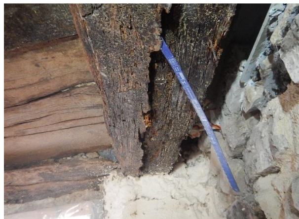
Figura 8. Fessurazione intradossale con degrado per carie.
