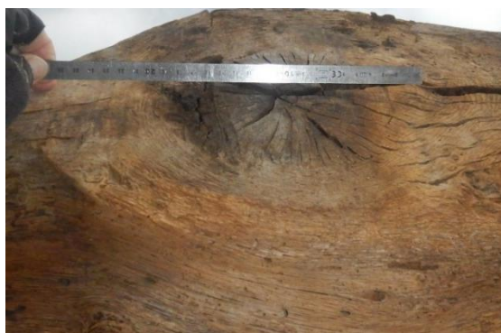
Figura 1. Valutazione dimensioni difetto su trave.
