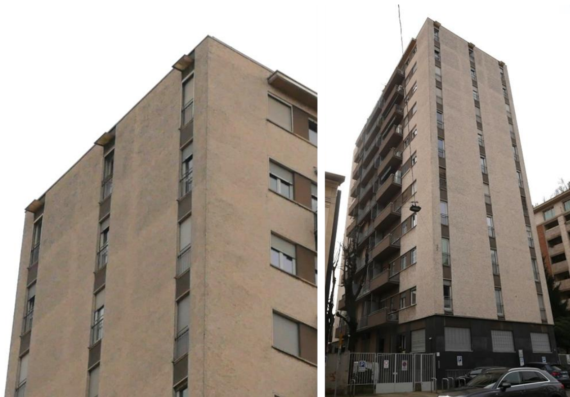
Figura 5. Pre-intervento (facciata nord): si noti l'identificazione chiara dell'orditura in cemento armato.
