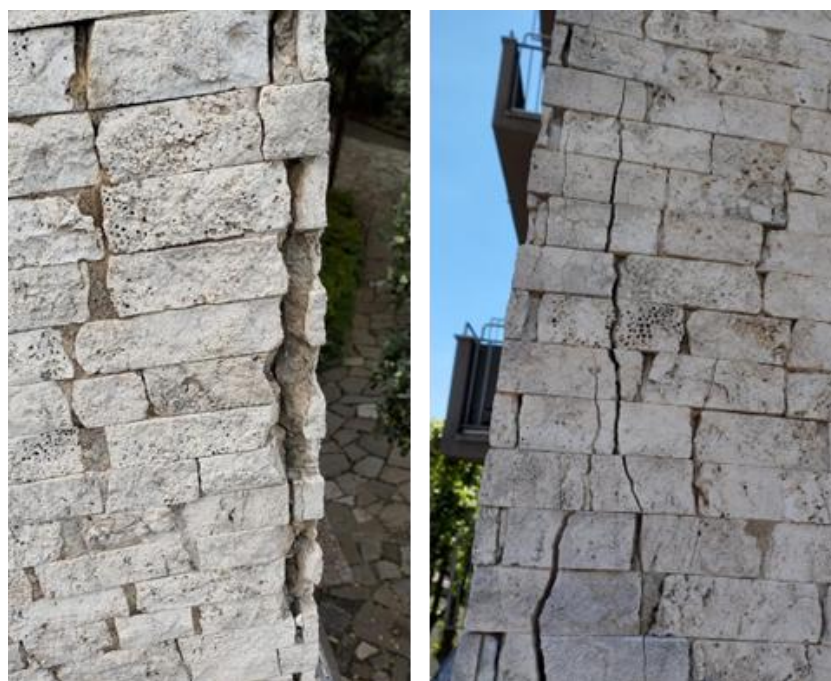
Figura 12. Battitura in corda: fessurazioni.
