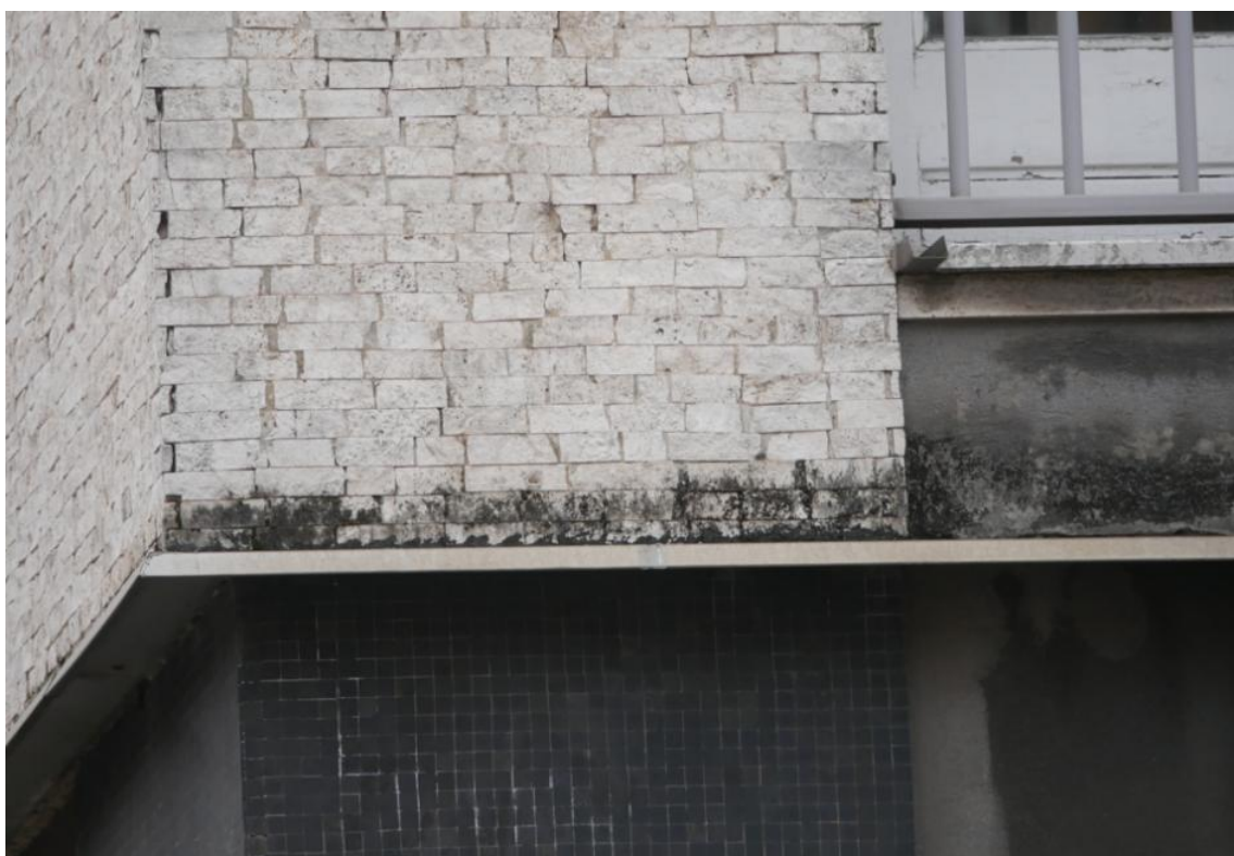
Figura 6. Pre-intervento (facciata nord): macchie e croste lungo i bordi inferiori del rivestimento in spaccatello.
