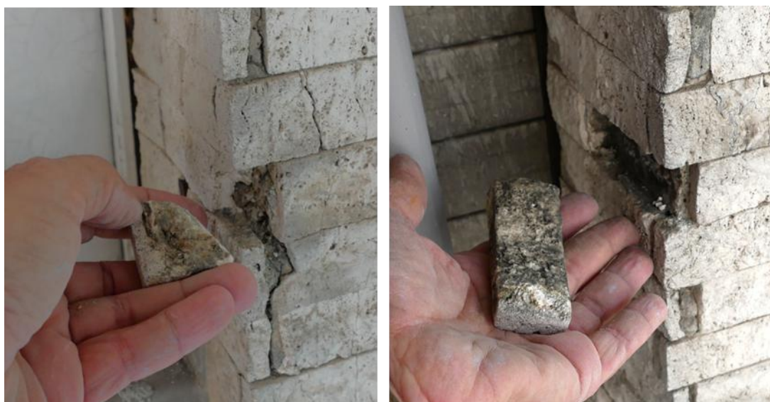
Figura 27. Pre-intervento: distacco dello spaccatello in corrispondenza delle spallette delle aperture, con ammaloramento dello strato di allettamento.
