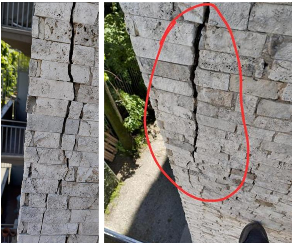
Figura 13. Battitura in corda: fessurazioni.
