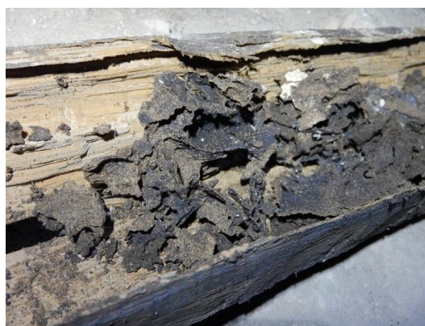
Figura 12. Attacco termiti su trave.
