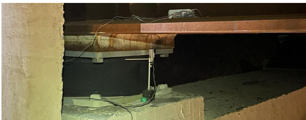
Figura 7. Appoggio: trasduttori di spostamento piezoelettrici installati sugli isolatori (tripla disposizione a 120^\circ ).
